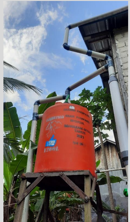
Instalasi Pemanenan Air Hujan
